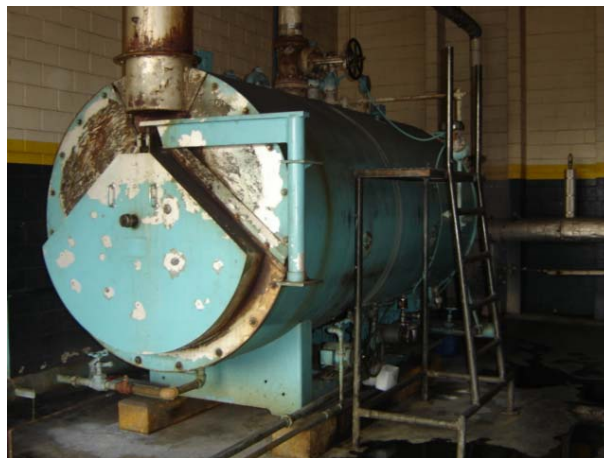
FIGURA 14. Caldera de vapor
