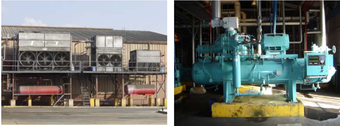
Figura 21. Torre de enfriamiento y compresor
