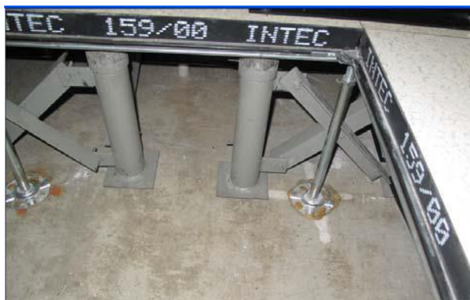
Figura 5. Piso elevado antiestático
