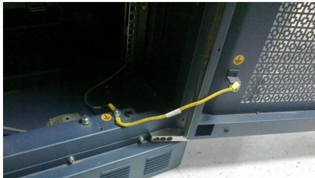
Figura 17. Cable de puesta a tierra para gabinetes
