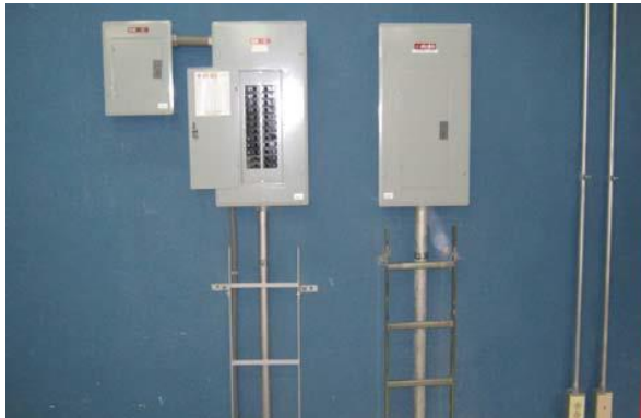
Figura 8. Tablero energía sitio A.1
