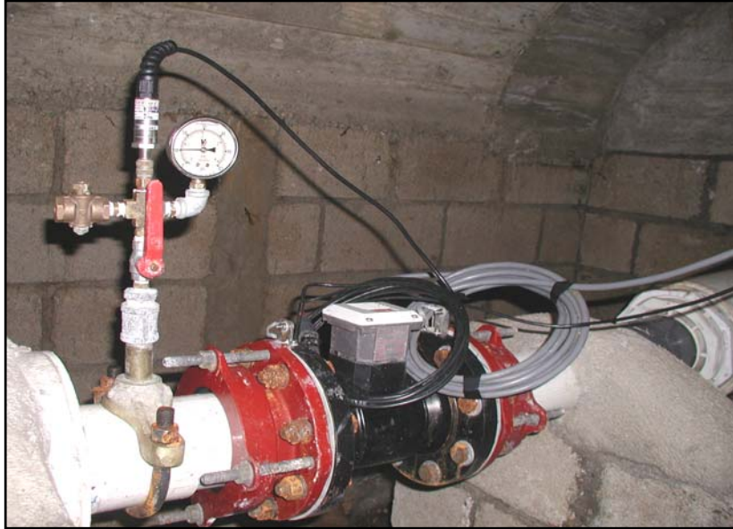
Figura No. 13 Macro medidor instalado
