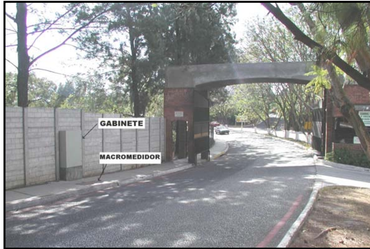
Figura No. 12 Ubicación del macro medidor y el gabinete utilizado
