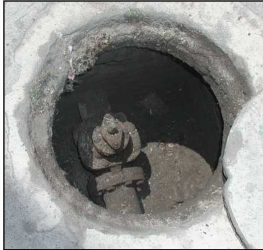
Figura No. 15 Estado de válvulas
