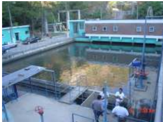
Figura No. 12 Tanque de compensación
