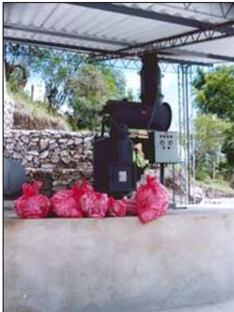
Figura 4. Incinerador de desechos hospitalarios
