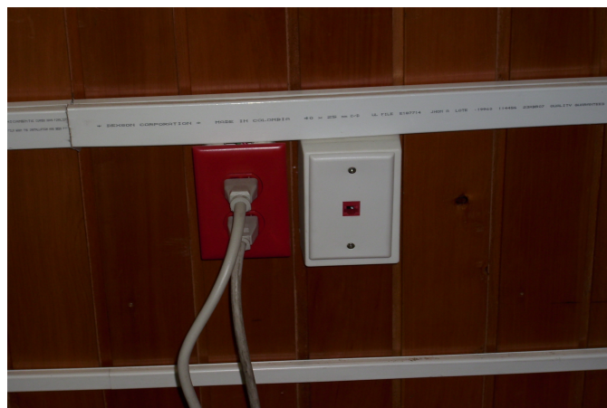
Figura 6. Punto de red instalado en Escuela De Ciencias y Sistemas
