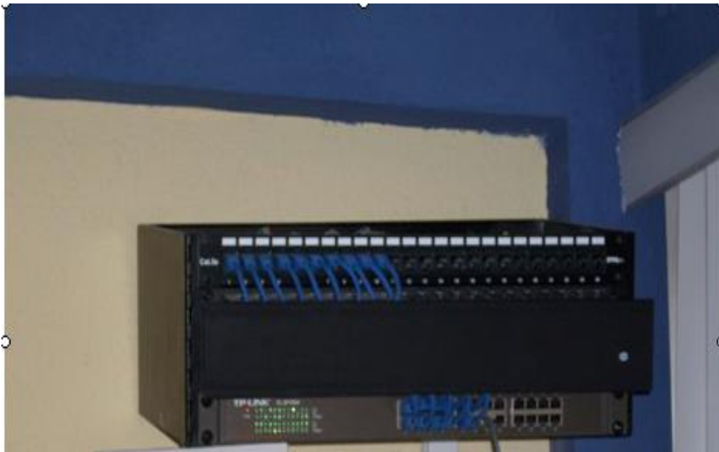
Figura 7. Switch de 24 instalado en Escuela de Ciencias y Sistemas
