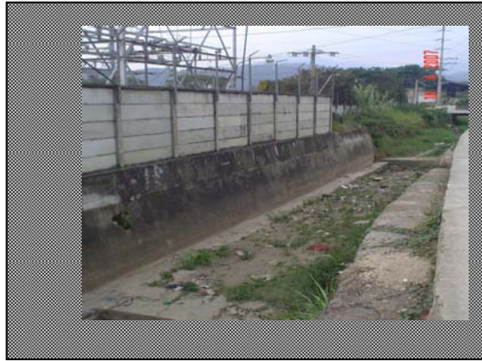
Fotografía 10 Incorporación de subestación eléctrica dentro de la margen de inundación derecha, 200 m aguas abajo del puente Chipilapa.
