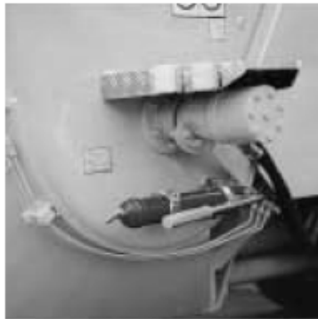
Figura 32. Lubricación central en tolva
