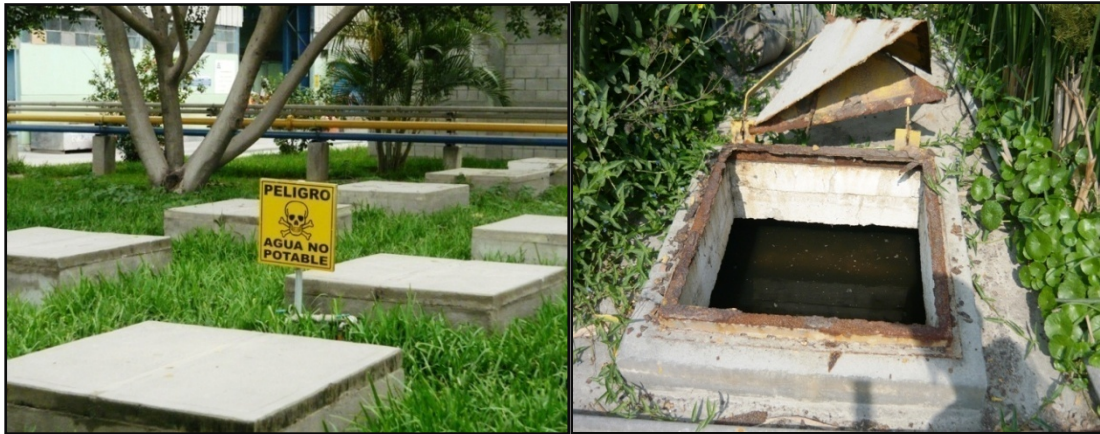
Figura 20: Tapaderas cerradas y otras en mal estado
