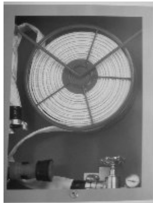
Figura 27. Boca de incendio equipada (BIE)
