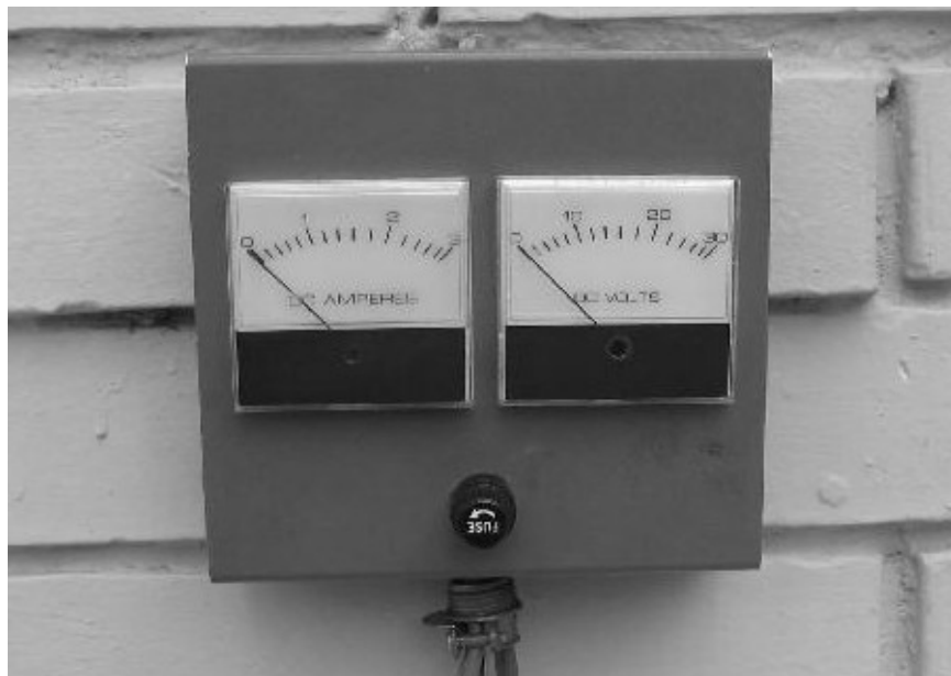
Figura 11. Medidor de voltaje y amperaje
