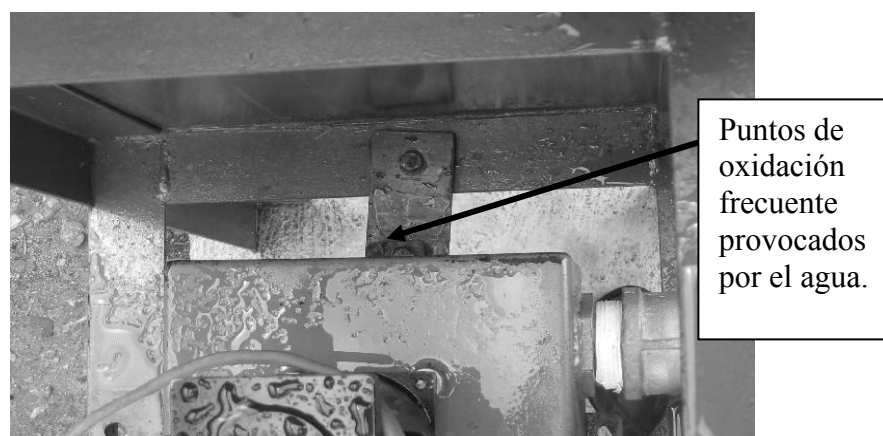
Figura 18. Puntos de oxidación en la estructura de la turbina.
