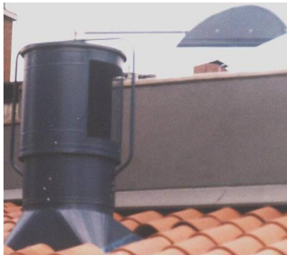
Figura 34. Extractor de aire tipo ventury.
