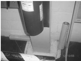
Figura 16. Rollo de plástico en lugar inadecuado
