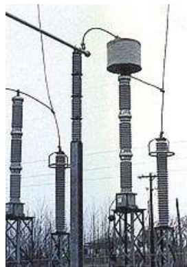
Figura 12. Trampa de onda sobre transformadores de tensión
