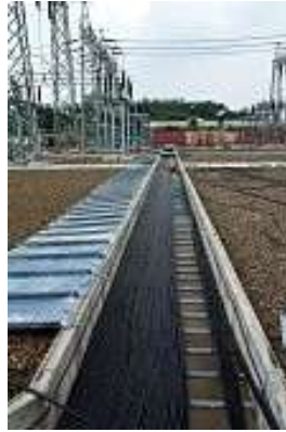
Figura 5. Cableado en las subestaciones
