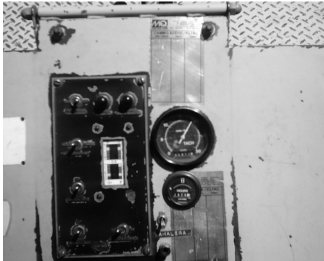
Figura 105. Tablero central de controles e indicadores
