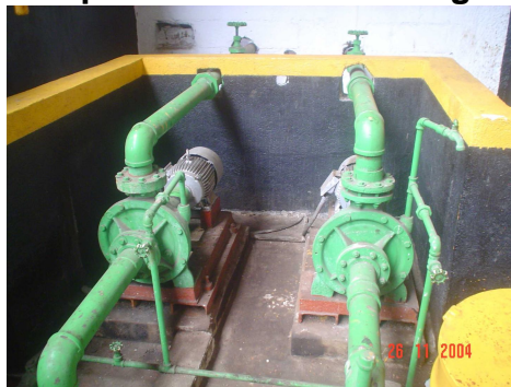
Bombas de agua
