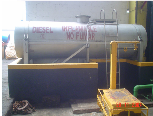
Depósito de diesel
