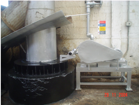
Bomba de bunker
