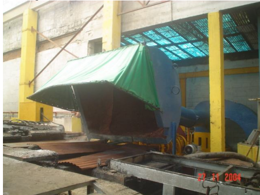
Campana para la extracción de humos
