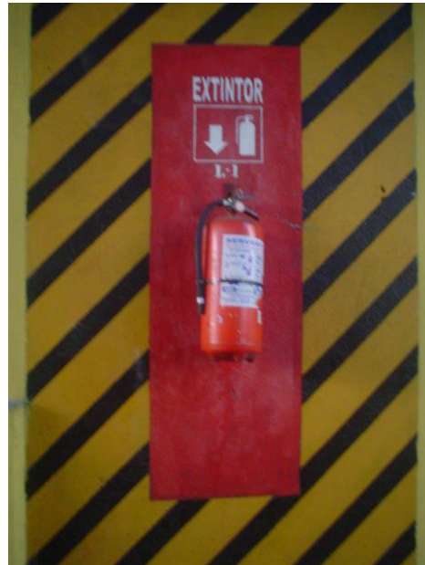
Extintor de fuego
