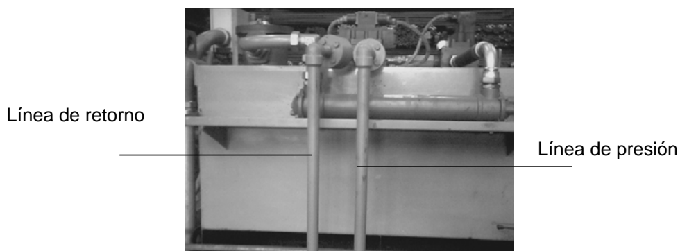
Figura 38 Identificació de las líneas de presión y de retorno
