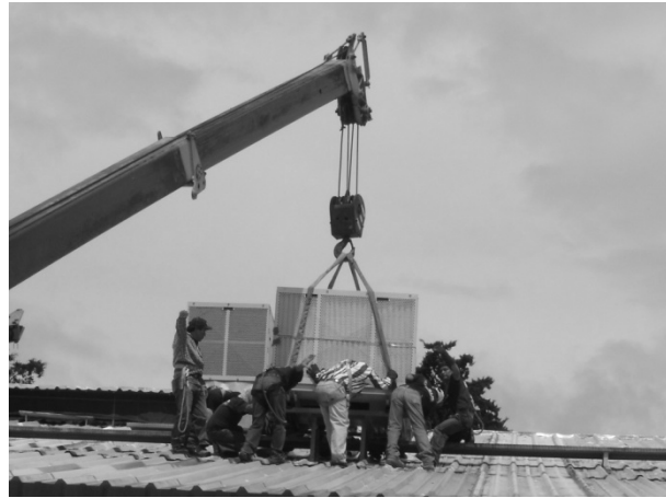
Figura 27. Instalación de equipo de inyección tipo ABB, modelo RGML 210
