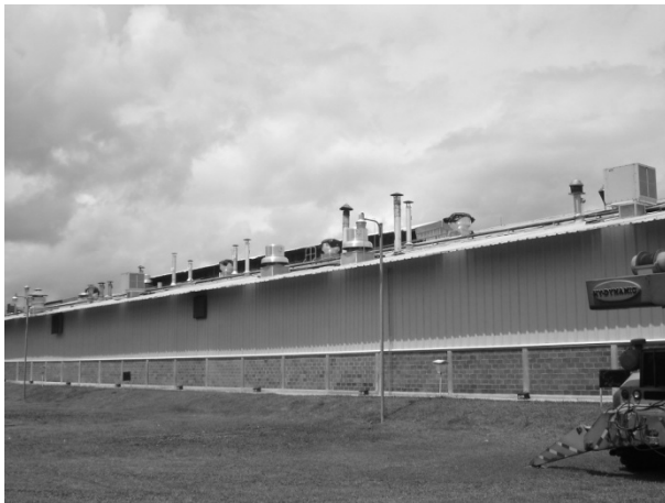
Figura 28. Equipo de inyección tipo ABB, modelo RGML 210 y extractor Soler & Palau, modelo CRV 26, instalados
