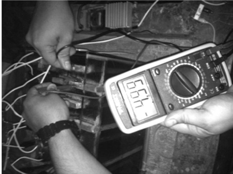
Figura 17: Voltaje entre placas unidad de electrocoagulación
