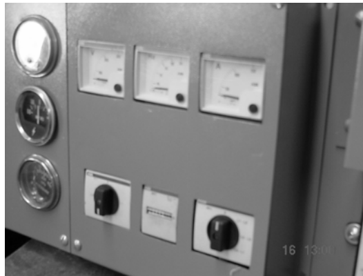
Figura 7. Panel de control de caseta acústica
