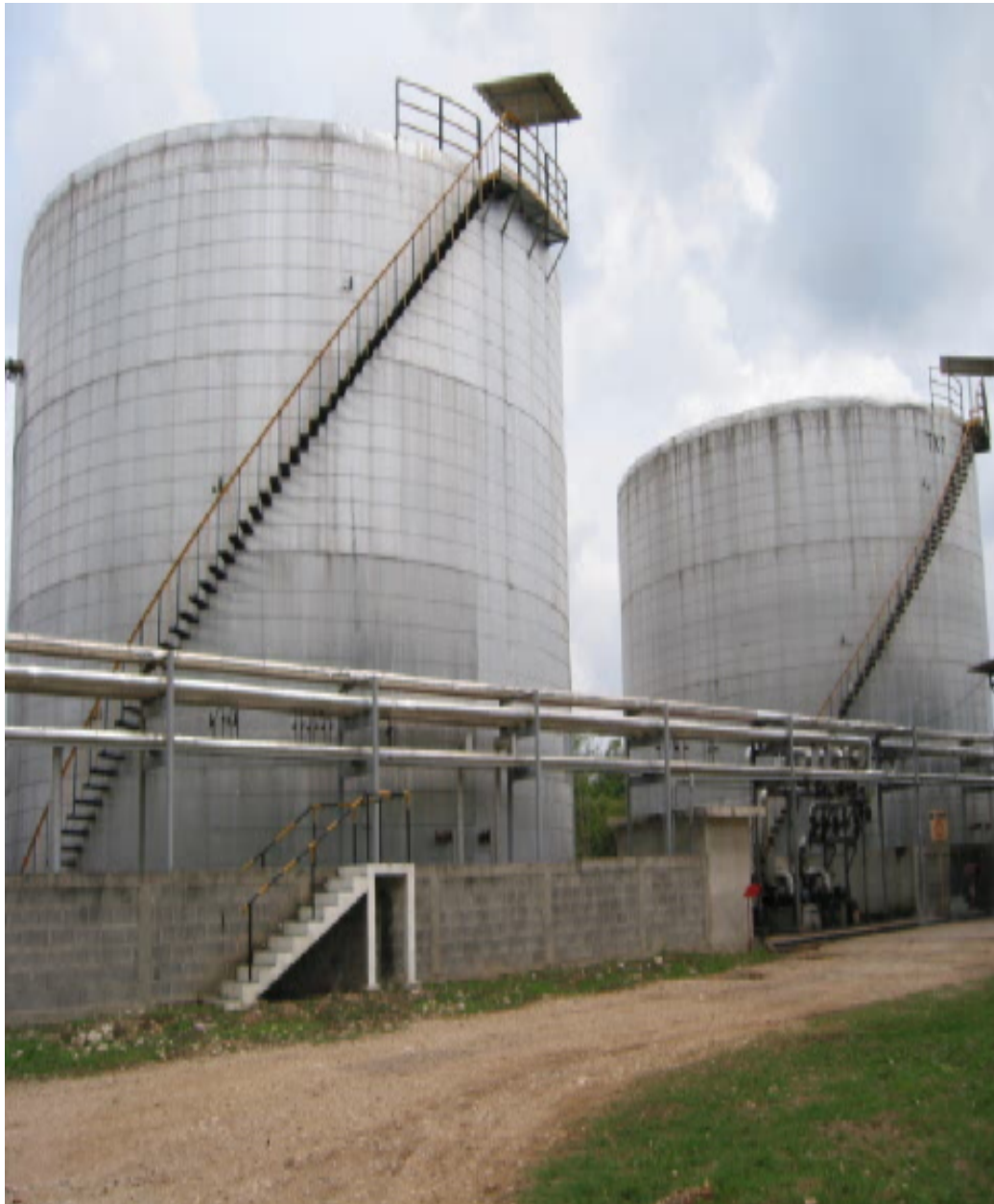
Figura 42. Tanques para almacenar Asfalto en la Refinería la Libertad
