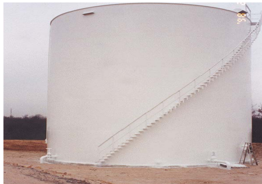
Figura 2. Tanque atmosférico vertical
