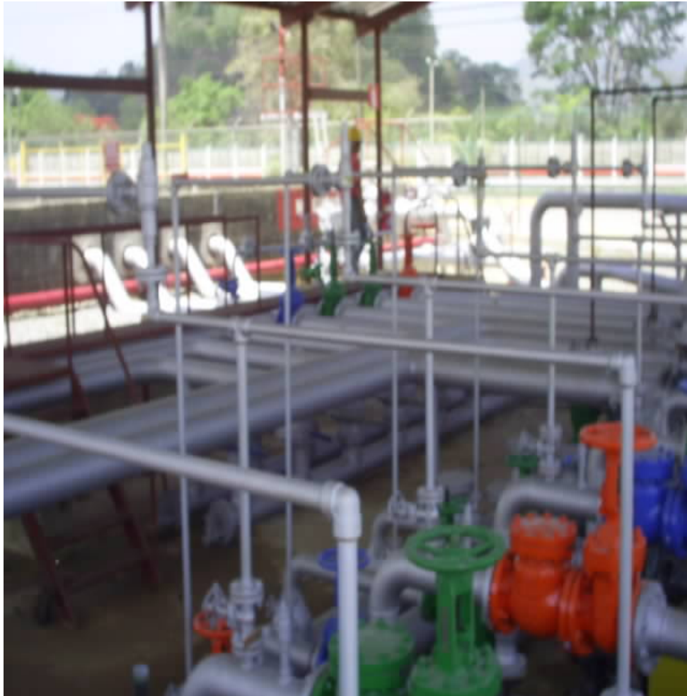
Figura 9. Área de sistemas de tuberías de carga y descarga.
