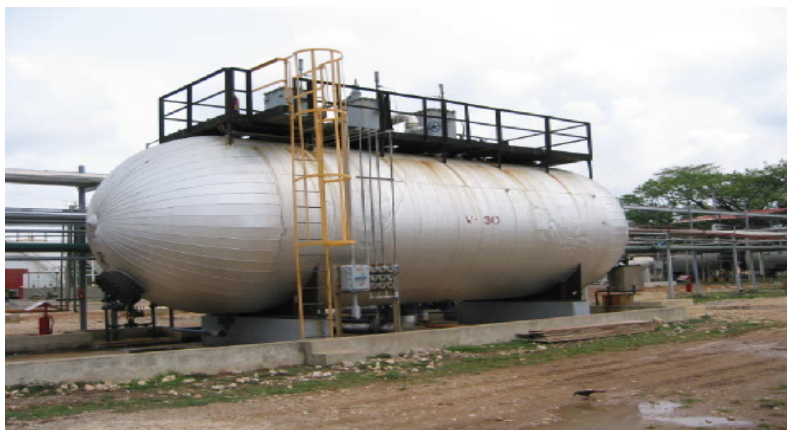
Figura 39. Desalinador V-30 existente en la Refinería la libertad
