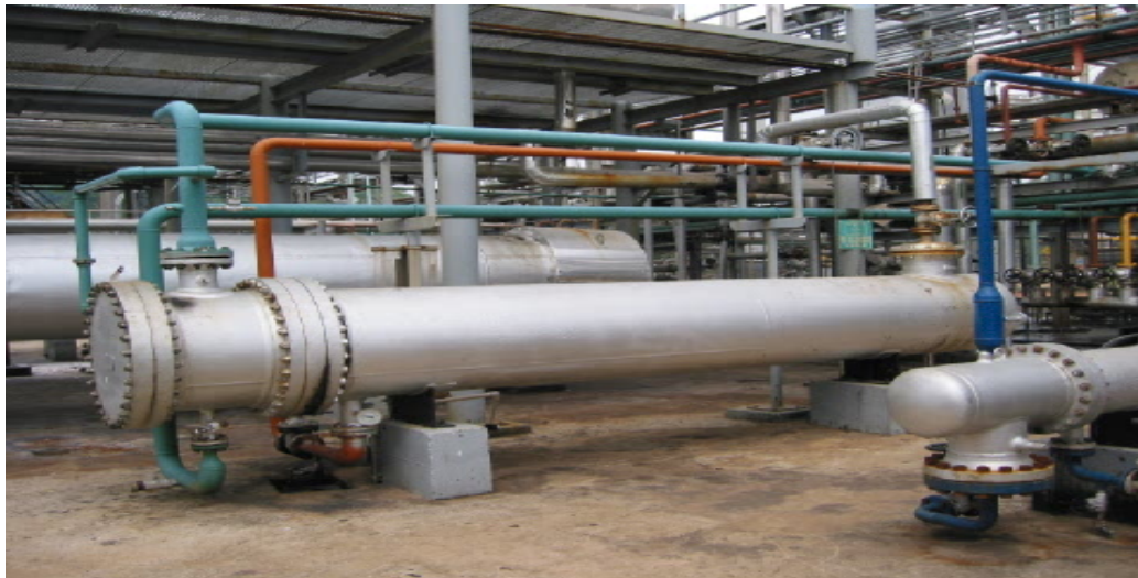
Figura 38. Intercambiador de calor I-18 existente en la Refinería la Libertad
