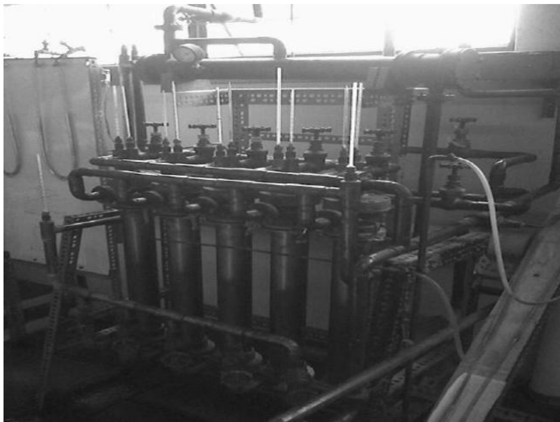
Figura 8. Termómetros del intercambiador de calor de concha y tubos
