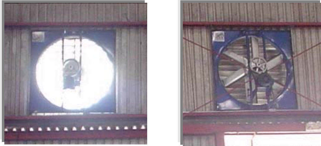
Figura 19. Extractores de aire.
