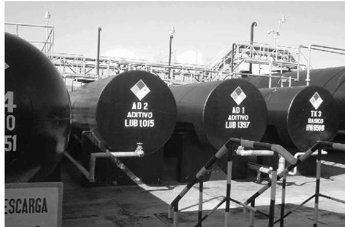
Figura 43. Tanques de almacenamiento.
