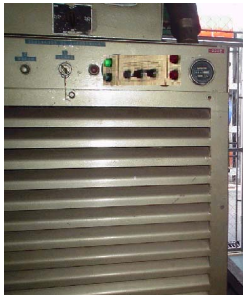
Figura 34. UPS (reguladores de voltaje).
