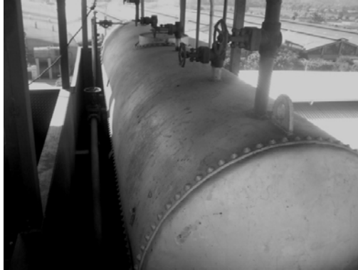
Figura 15. Tanque de expansión de aceite térmico
