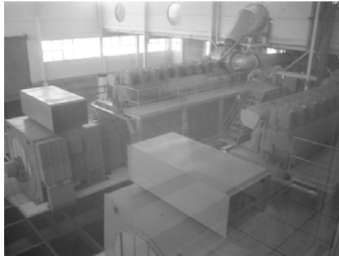
Figura 2. Planta Generadora GCA
