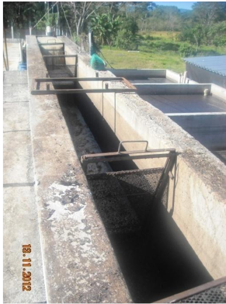
Figura 4. Canal de rejas para tamizado de agua miel
