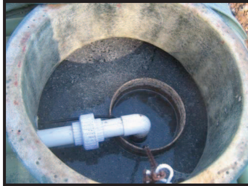
Figura 49. Segundo módulo de sedimentación
