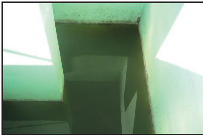
Figura 42. Cámara de contacto
