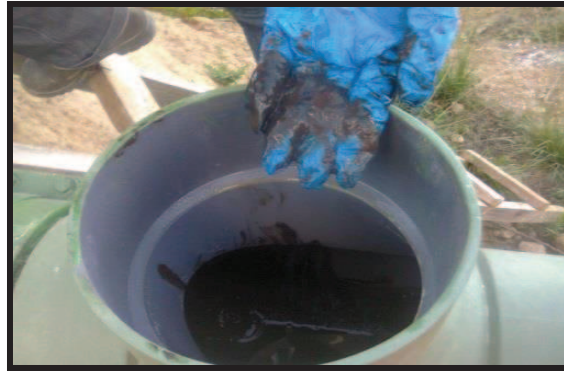
Figura 46. Tubería de conducción del efluente del sedimentador al hipoclorador
