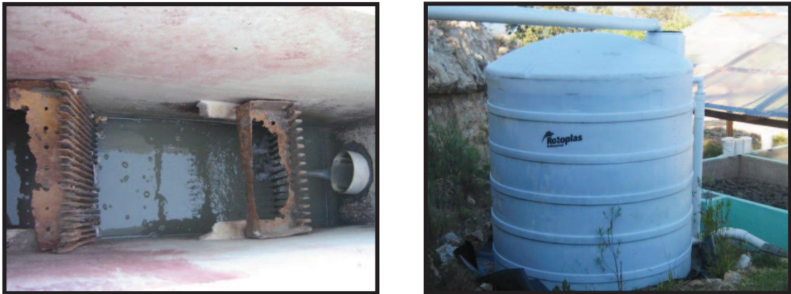
Figura 39. Canal de rejas y tanque condensador
