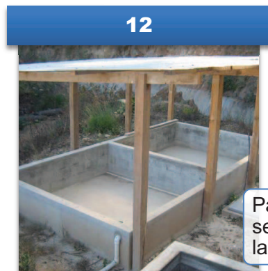
Cámara de contacto de la PTAR 1
