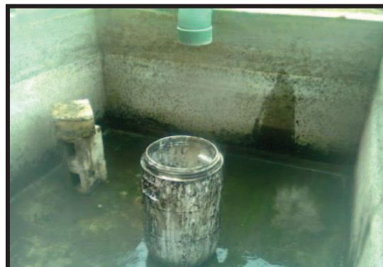
Figura 50. Cámara de contacto
