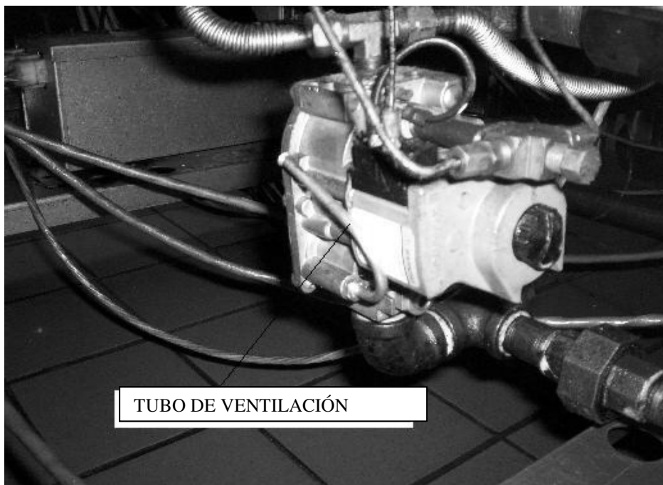
FIGURA 23. Tubo de ventilación válvula de gas
