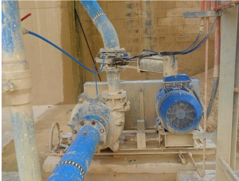
Fuente: estación de bombeo de lodos.
