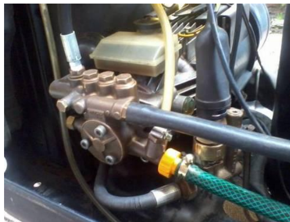
Figura 53. Tubería principal de conducción de agua de alta presión
