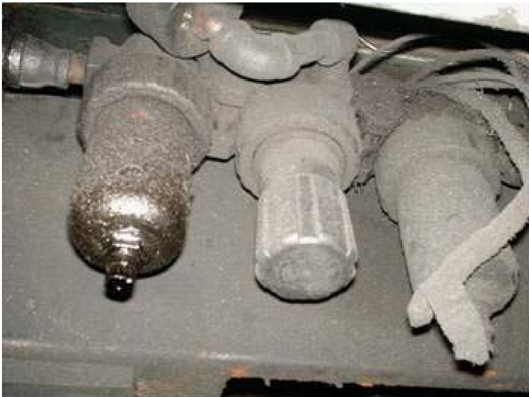
Figura 10 Unidades de mantenimiento neumático de las máquinas
