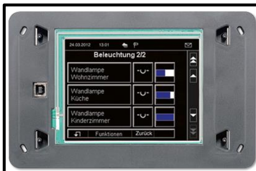
Figura 47. Módulo de control principal modelo FP 701 CT IP
