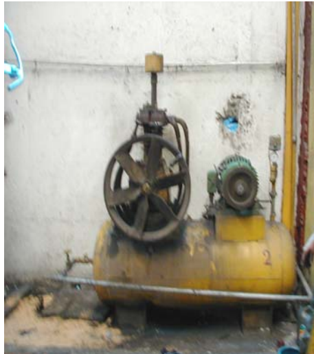
Compresor No. 2, Capacidad 45 CFM
