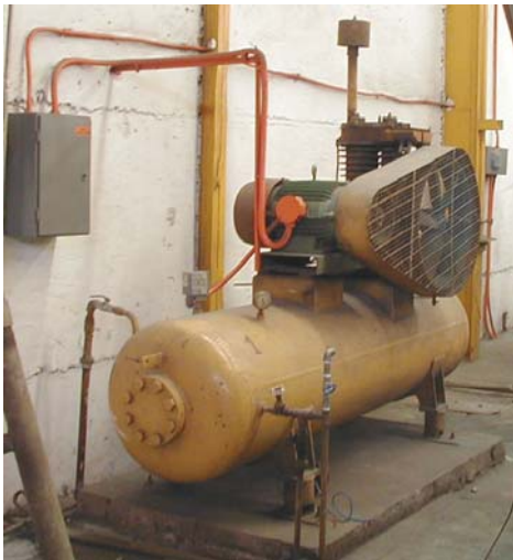
Compresor No. 1, Capacidad 45 CFM
