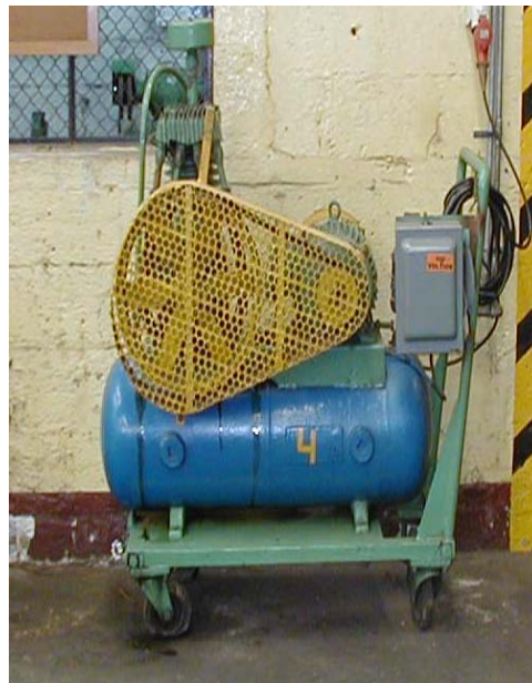
Compresor No. 4, Capacidad 27.4CFM
