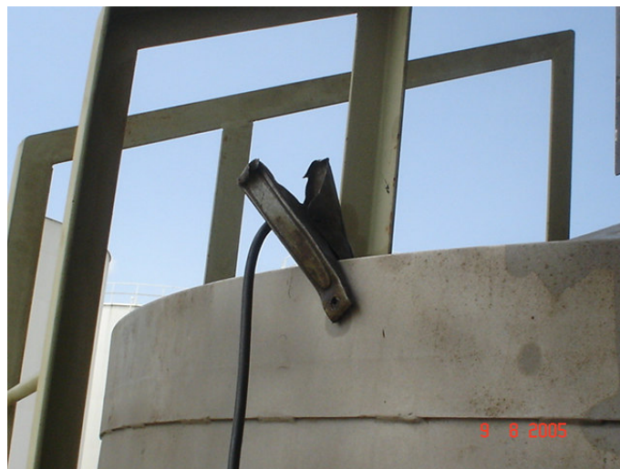
Figura 10. Conexión a tierra
