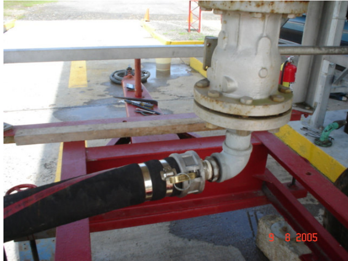
Figura 11. Conexión de la manguera al probador volumétrico.
