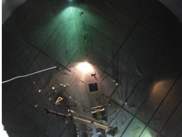
Figura 80. Vista de ductos de aireación desde ápice
