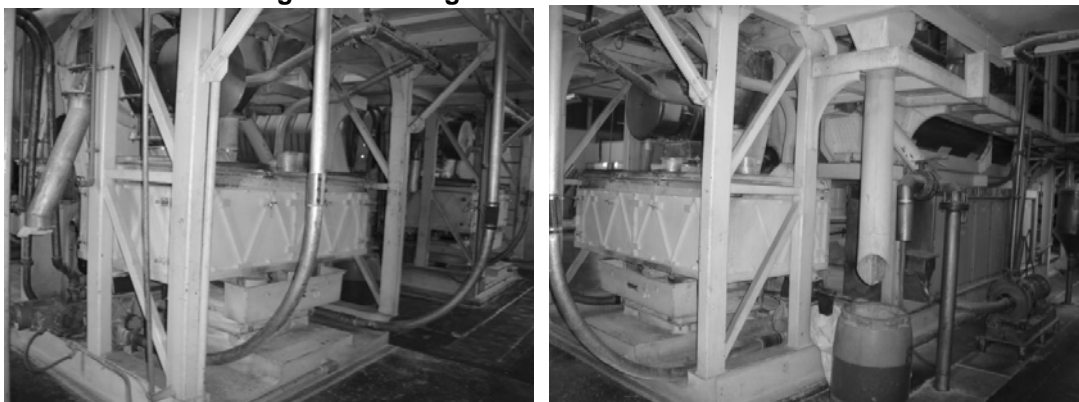
Figura 20. Fotografía vista frontal de Unidad 1
