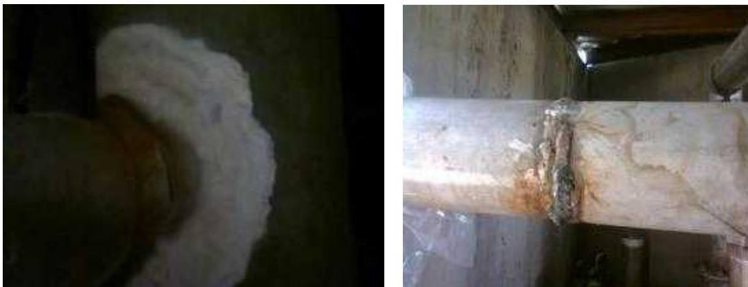
Figura 11. Tubos de acero inoxidable con fisura en zona soldada
