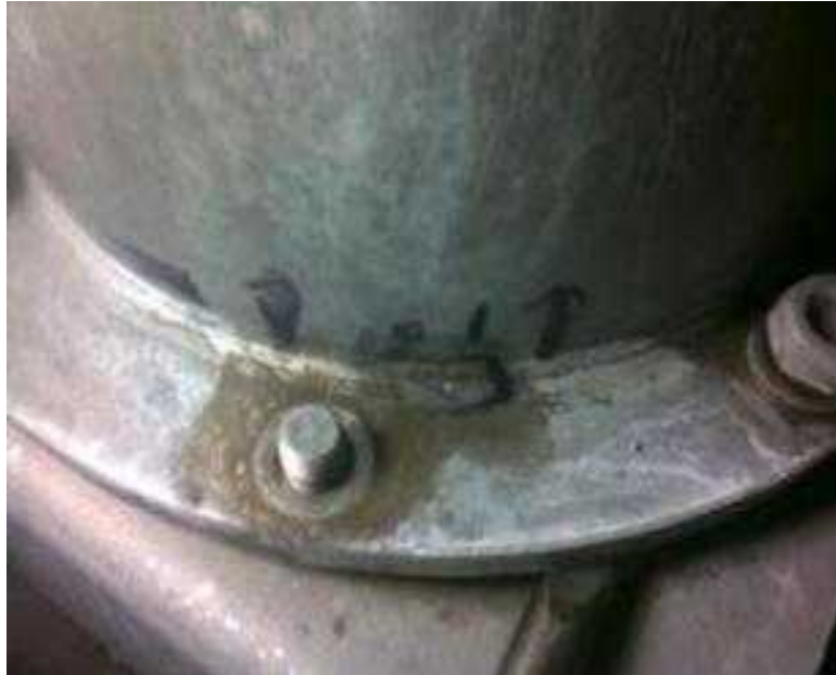
Figura 9. Intercambiador de calor con fisura en zona de soldadura
