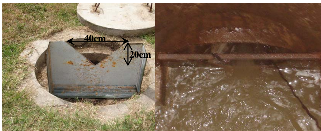
Figura 8. Vertedero triangular colocado en pozo PV16.
