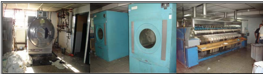
Figura 24. Lavandería, lavadoras, secadoras y área de planchado (mangle).
