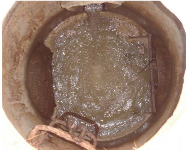
Figura 6. Incrustaciones de residuos de hipoclorito de calcio en las paredes del pozo PV16
