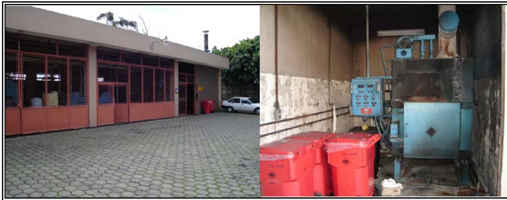
Figura 21. Área de Casa de Máquinas donde se ubican las calderas e incinerador (Actualmente, el incinerador no es utilizado)
