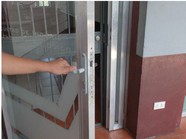
Chapas de puertas de vidrio de los laboratorios del ITCoE
