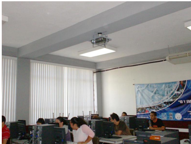
Vista panorámica de jaula e instalación eléctrica de proyector en el laboratorio No. 1 del ITCoE
