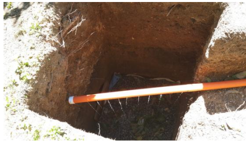
Figura 16. Tubo de distribución de caudal en el suelo
