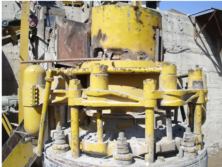
Figura 34. Condición actual de trituradora tipo cono
