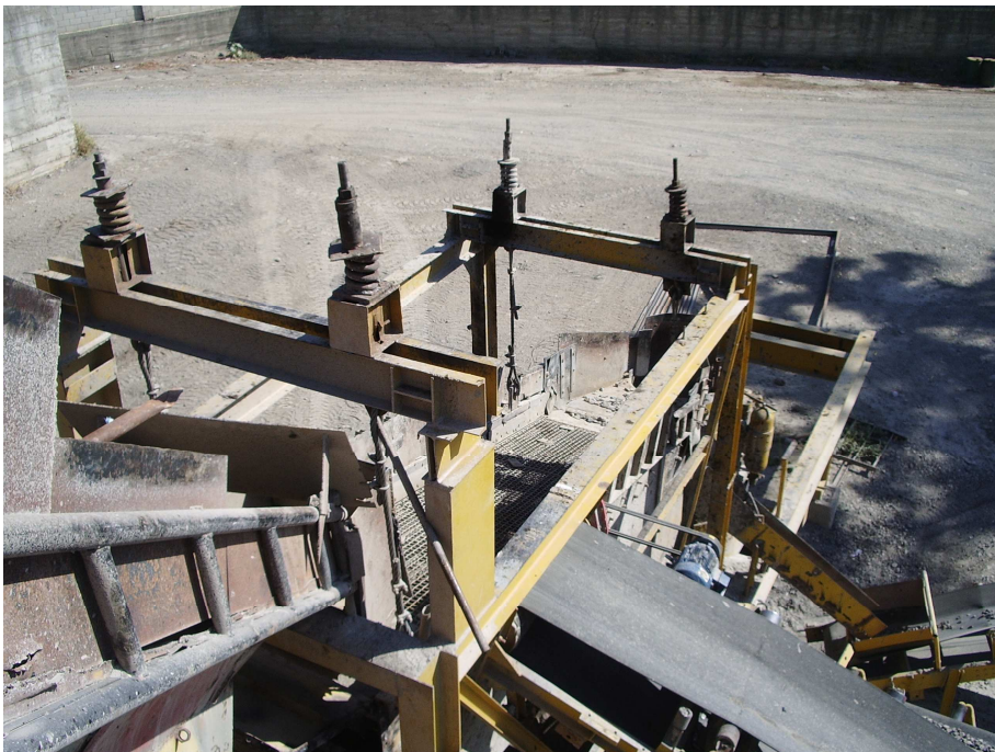
Figura 26. Estructura de soporte de zaranda secundaria
