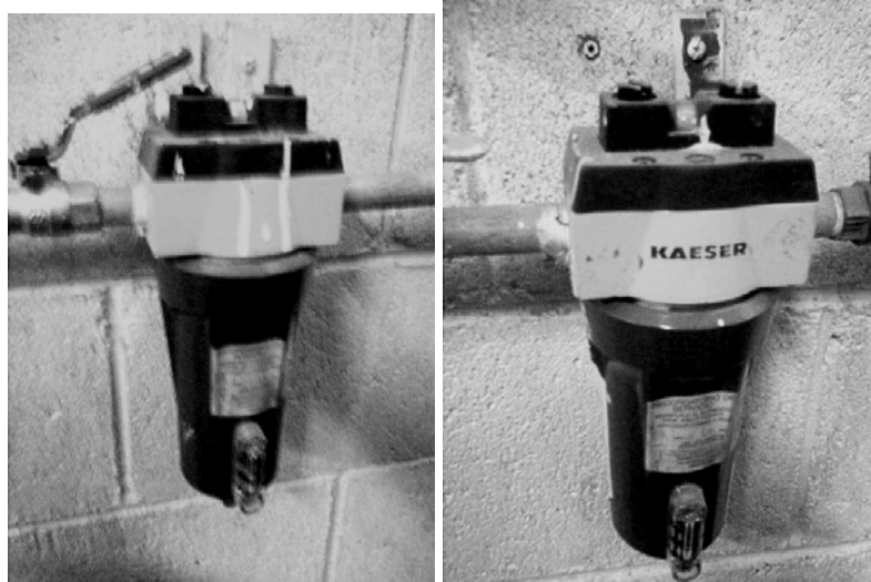
Figura 30. Filtros de agua y aceite instalados
