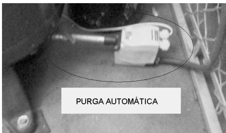
Figura 29. Purga automática instalada
