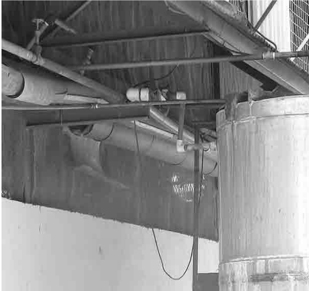
Figura 2. Instalaciones mecánicas inseguras
