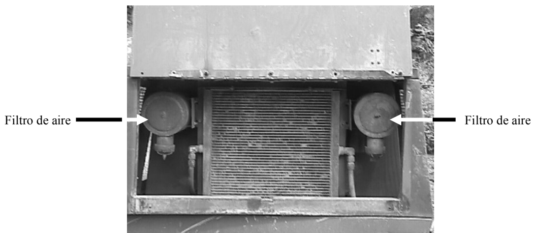
Figura 15. Filtros de aire del compresor
