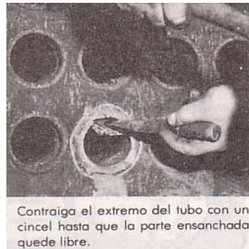
Figura 33. Desprendimiento del tubo
