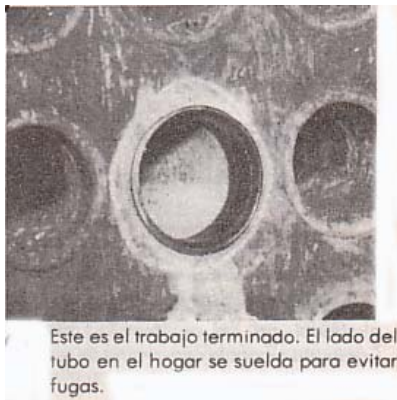
Figura 62. Tubo terminado o listo para soldar si es el lado de fuego
