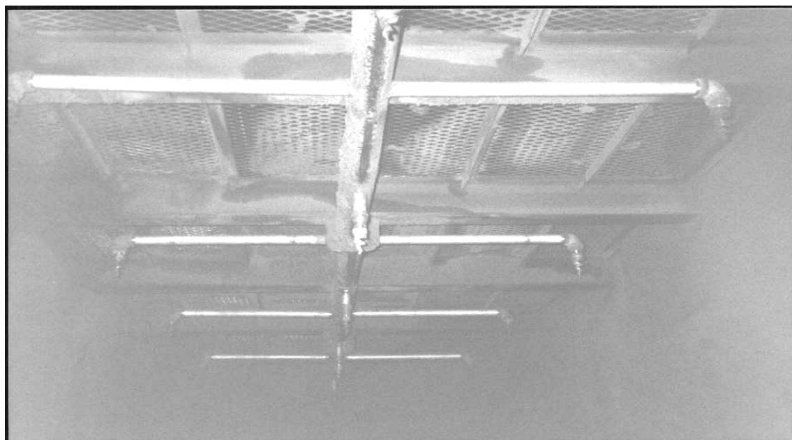
5) Toberas dentro del colector de hollín caldera 7 Ingenio Santa Ana
