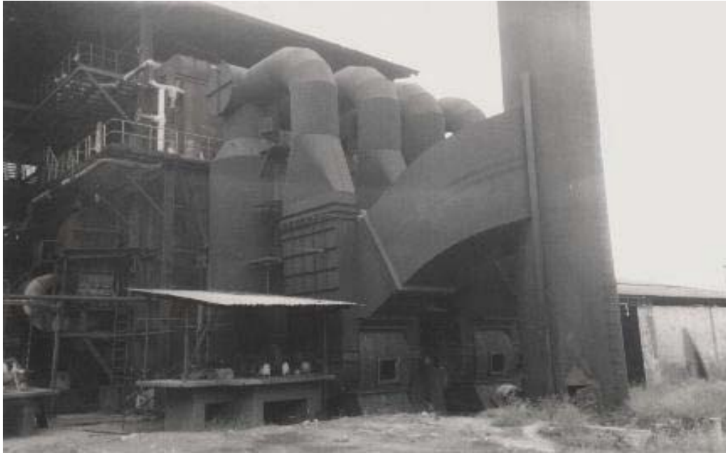
1) Colector de hollín, tiro inducido y chimenea de caldera 7 Ingenio Santa Ana
