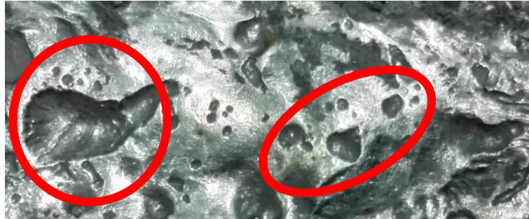
Irregularidades sobre cordón de soldadura
