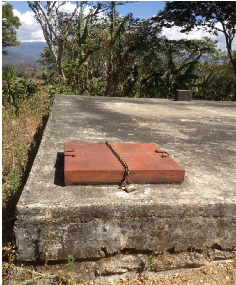
Figura 10. Tanque de distribución, sistema de agua Agua Blanca
