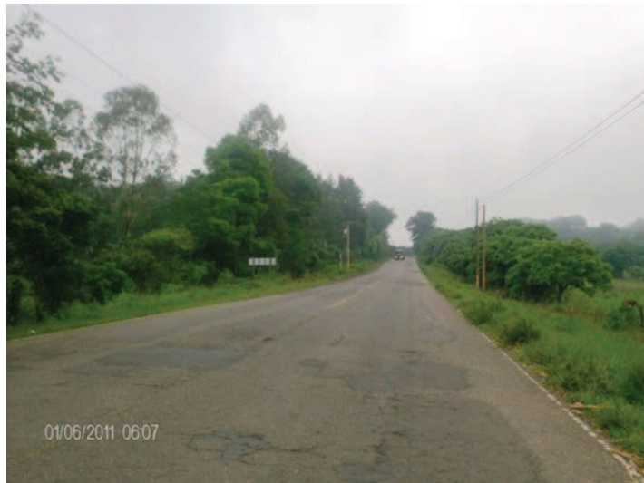
Figura 26. Fotografía señalización horizontal dañada, estación 91+800
