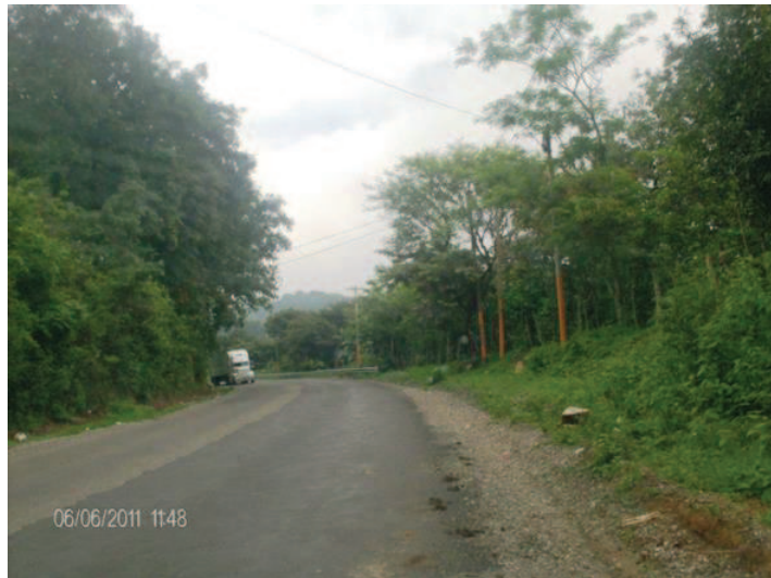
Figura 24. Fotografía señalización horizontal dañada, estación 91+050
