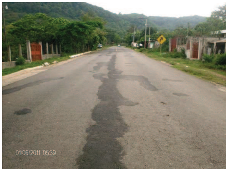
Figura 29. Fotografía señalización horizontal dañada, estación 95+000
