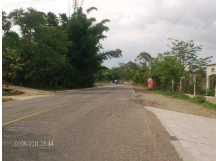
Figura 28. Fotografía señalización horizontal dañada, estación 94+300
