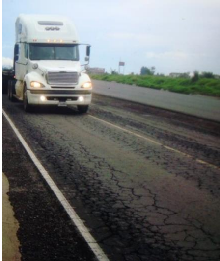
Figura 7. Falla cuero de lagarto en bloque.
