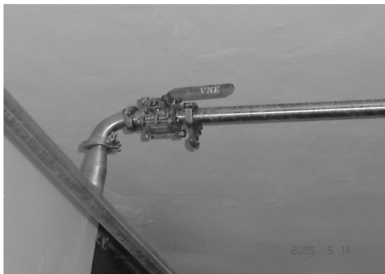
Figura 12. Tubería de servicio
